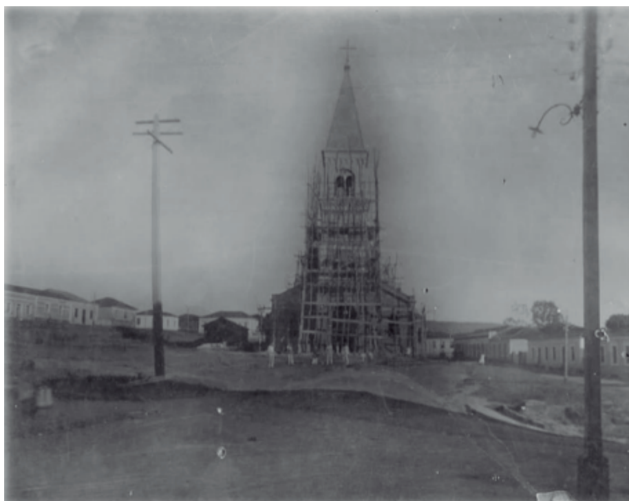
Construção da nova Igreja Matriz de São Francisco de Paula, na década de 1930. Fonte: Revista Comemorativa do Bicentenário de Fundação de Monte Santo de Minas - 1820/2020.
